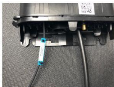
Au Point Branchement Optique PBO
